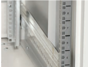
Цифровая маркировка на монтажных стойках
