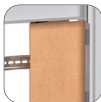
Электроизоляционный картон закрывает токоведущие части
